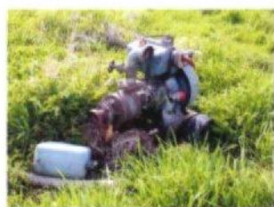
Pompe à l'abandon
