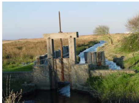
Dispositifs de régulation des eaux dans le marais
