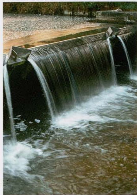
Petit barrage avec glacis pour l'aération du cours d'eau.
