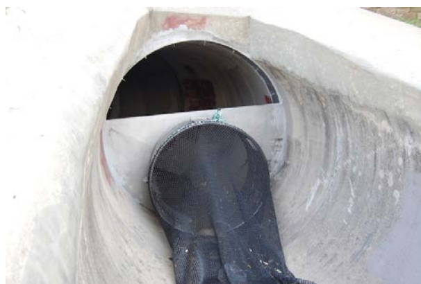
Illustration 21 : Filets sur exutoires (Crédit : Stormwatersystems)
