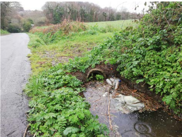
Illustration 4 : Déchets issus d'une route en zone périurbaine se retrouvant dans un fossé (Crédit : Florian Rognard, Cerema)
