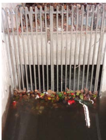
Illustration 19 : Dégrilleur à l'aval d'un exutoire pluvial (Crédit : Florian Rognard, Cerema)
