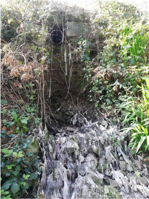
Illustration 3 : Point de rejet d'un réseau où de nombreux textiles sanitaires sont visibles (Crédit : Florian Rognard, Cerema)
