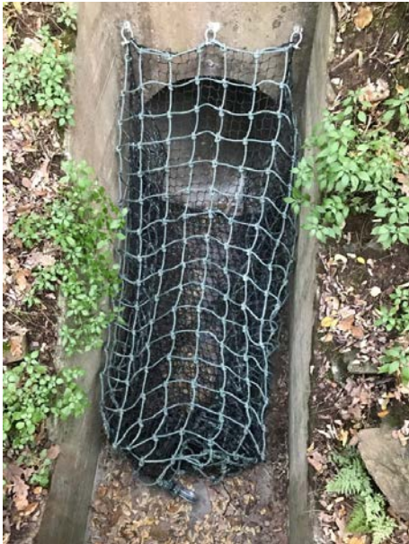
Illustration 23 : Filets sur exutoires pluviaux (Crédit : Pollustock)
