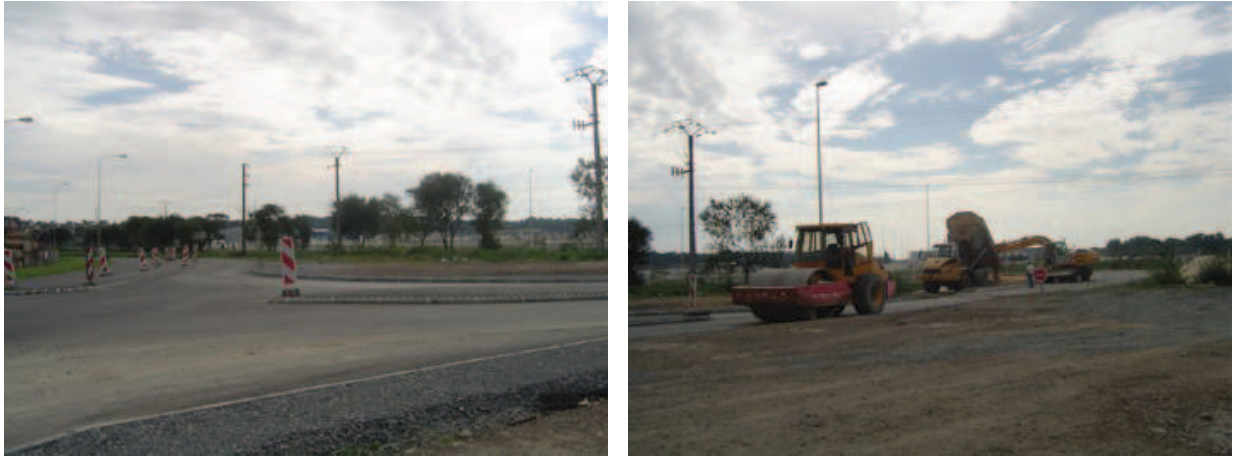
Début des travaux de la nouvelle voie portuaire dans la zone industrielle Caen-Canal
