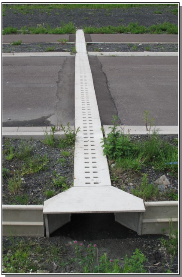
Exemple de tunnel peu profond : tunnel avec aération sur la chaussée Aco-Pro AT500 (photo © C. Eggert)
