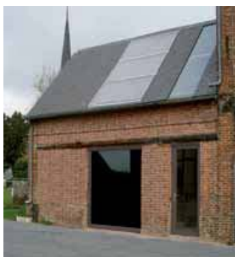
La pose de panneaux est cohérente avec les dimensions et le rythme des ouvertures en façade.
